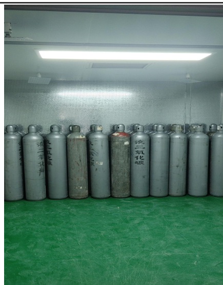
环氧乙烷贮存室以及喷淋设施
