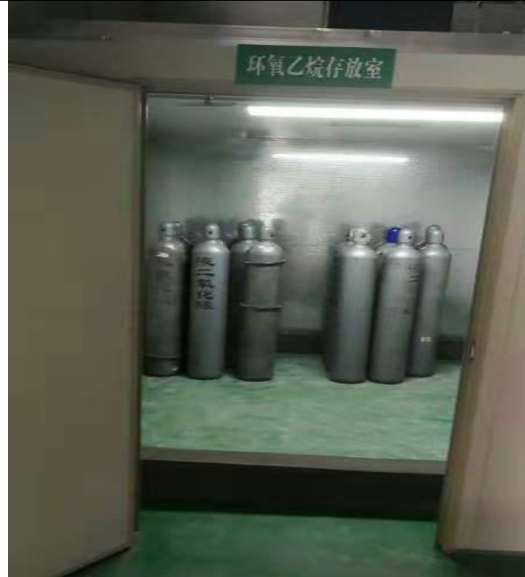
环氧乙烷存放室围堰
