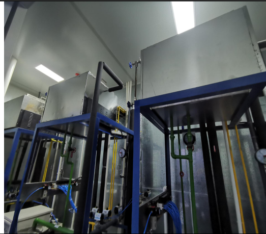
环氧乙烷废气吸收水箱
