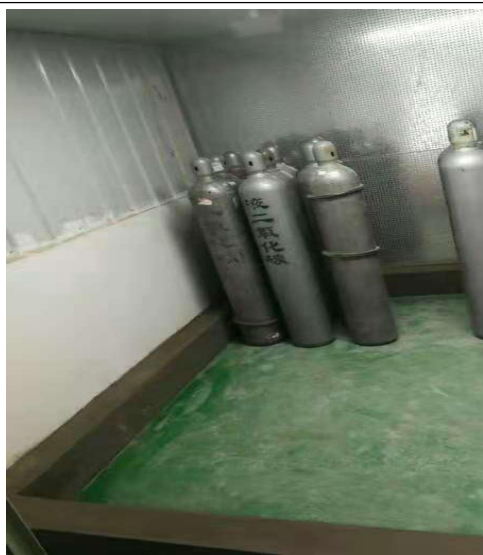
环氧乙烷存放室围堰
