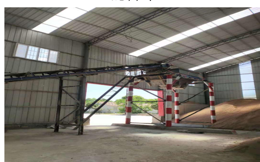
生产车间中水稳料出料口
